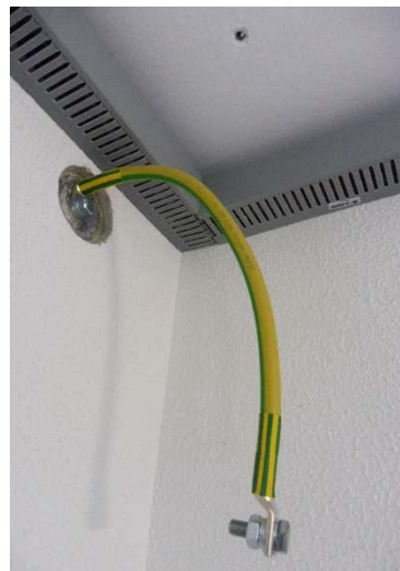
Fot. 3-19 Linka uziemiająca (uziemienie dachu i obudowy)
