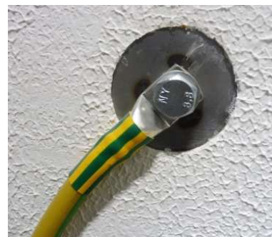
Fot. 3-33 Zacisk uziemiający (wyprowadzenie zbrojenia betonu).
