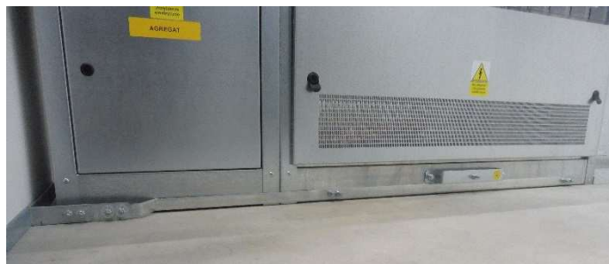
Fot. 3-14 Uziemięcie rozdzielnicy nN
