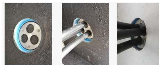
Fot. 6-2. Przykłady zamontowanych przepustów.
