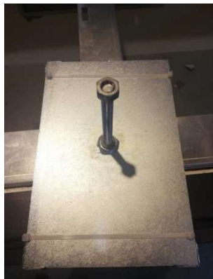
Fot. 3-8 Stopa pod transformator.
