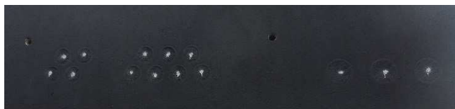
Fot. 6-3 Przepusty kablowe nN i SN.
