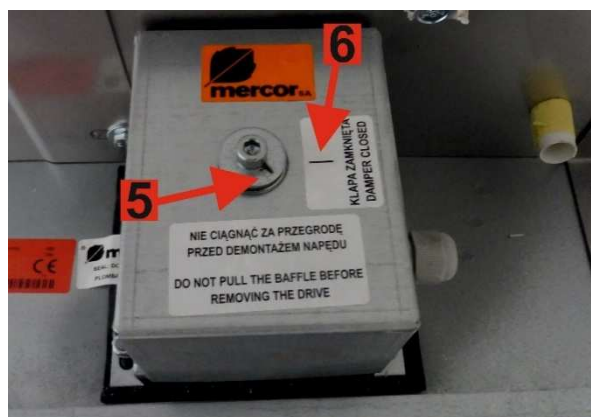
Fot. 3-47 Zewnętrzny mechanizm napędowy
