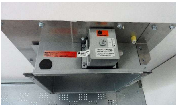
Fot. 3-41 Klapa p.poż. – widok z zewnątrz
