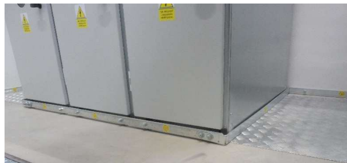
Fot. 3-15 Uziemięcie rozdzielnicy SN
