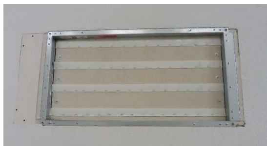
Fot. 3-39 Klapa przeciwpożarowa zamontowana w stacji
