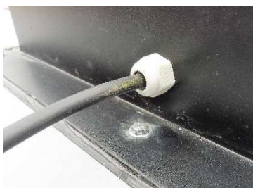
Fot. 4-46 Przewód zasilający transformator przeprowadzony przez dławik
